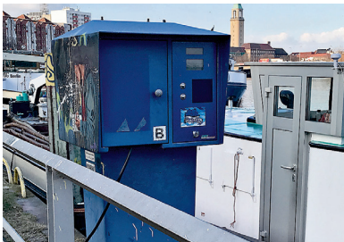
Auftanken: Stromsäule in Spandau
